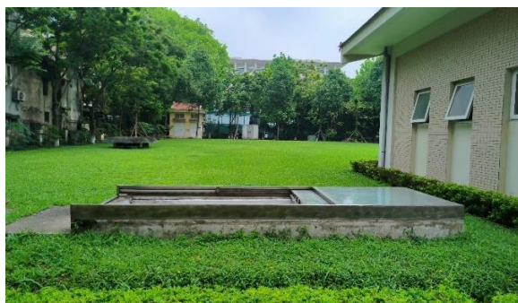
Thảm cỏ và hệ thống thông gió trên hệ thống XLNT đặt ngầm của Trạm
