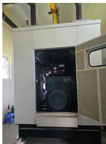
Khu vực đặt máy phát điện của cơ sở
