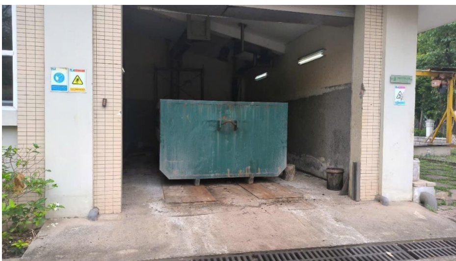
Hình 3.19: Thiết bị chứa bùn của Trạm XLNT
