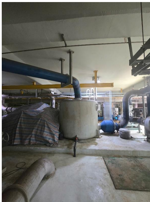
Hệ thống xử lý mùi bằng than hoạt tính
