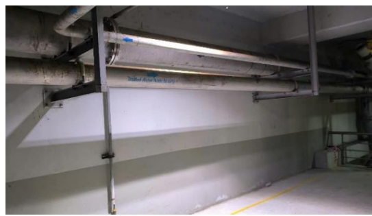
Hệ thống đường ống dẫn nước thải sau xử lý ra nguồn tiếp nhận
