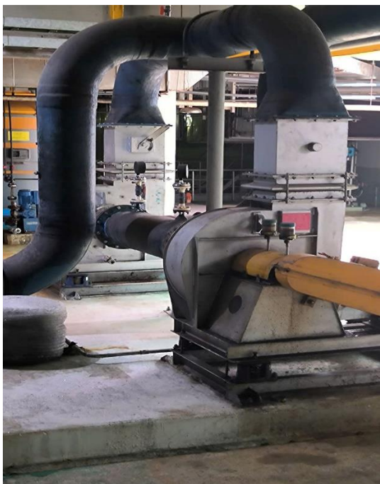
Hệ thống ống thu gom mùi và quạt hút
