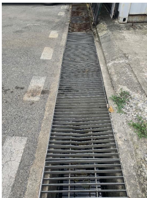
Hình 3.2: Mương chữ U thu gom nước mưa trong khuôn viên cơ sở
